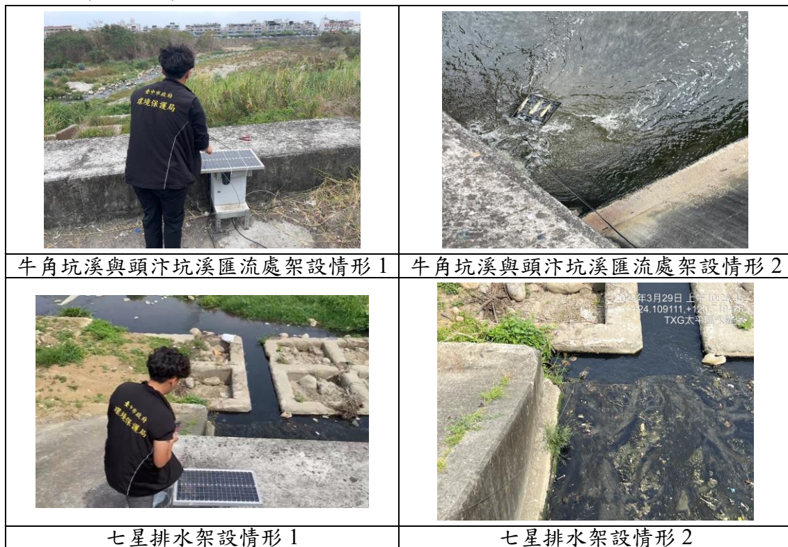
圖 4、環保局新增移動式水質感測器架設情形
