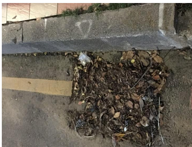
前次大雨後排水孔已遭落葉、雜物覆蓋
