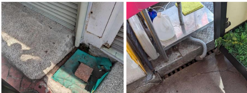
排水格柵幾乎遭覆蓋阻隔
