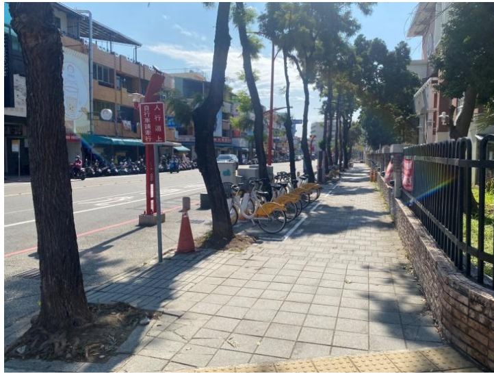
圖 30 東榮路人本改善工程改善前-樹木浮根、公共設施帶未整合
