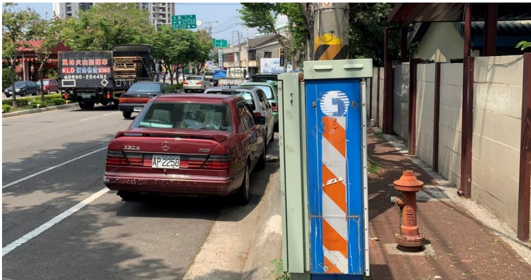
圖 22 雅潭路二、三段人本改善工程改善前-私人物品佔用、無通行空間
