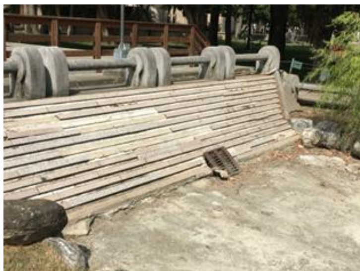
南北池聯通管路管徑過小
