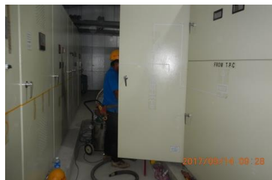
弱電設備配線
