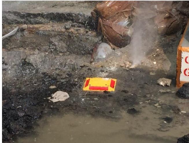
圖 3.漢視瓦斯公司安裝於地面上標示管線位置逕自開挖
