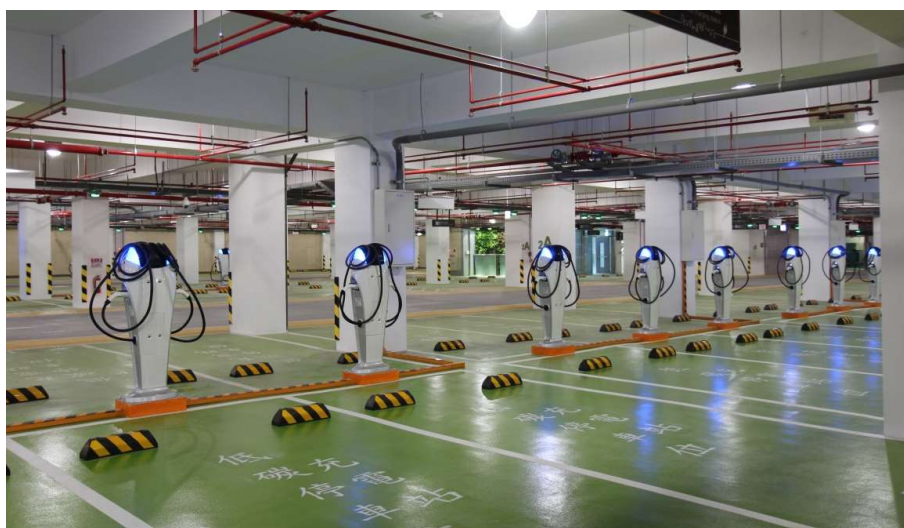
水湳地下停車場電動充電樁實景照片
