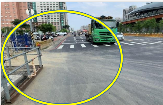
營建工地造成之路面污染情形
