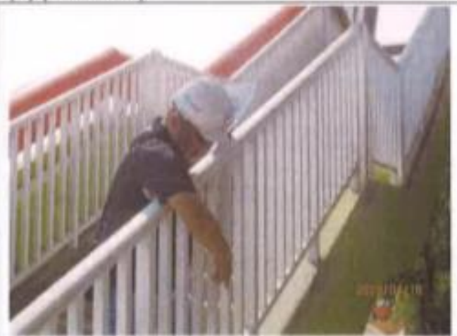
照片(12) 11.(2)戶外梯欄杆基座打除安裝基座修補未完整。(L)(5.08.02)
