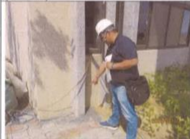
照片(11) 11.(1)外牆抹石子缺角破損。(L)(5.08.02)
