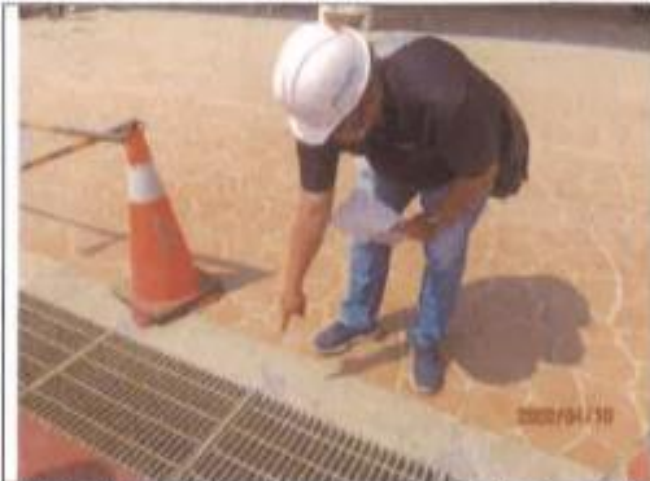
照片(7) 8.(6)跑道旁側溝混凝土面插銷處，已部分破損。(L)(5.07.01.99)
