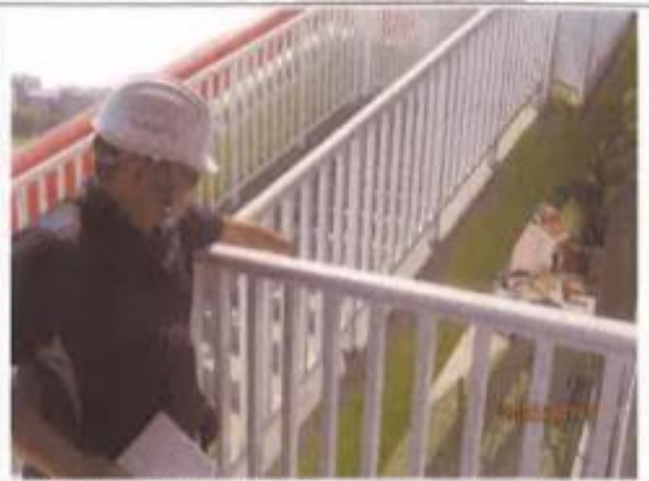
照片(8) 8.(7)戶外梯欄杆基座打除安裝基座修補未完整。(L)(5.07.01.99)
