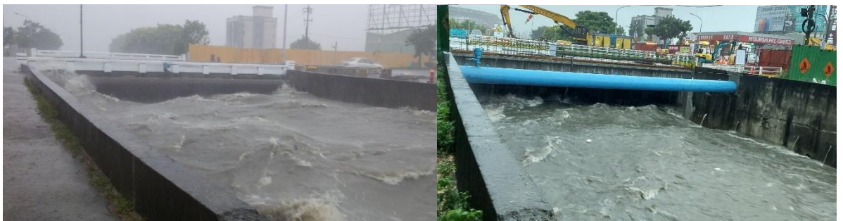
牛埔橋改善前河川暴漲淹水現況
