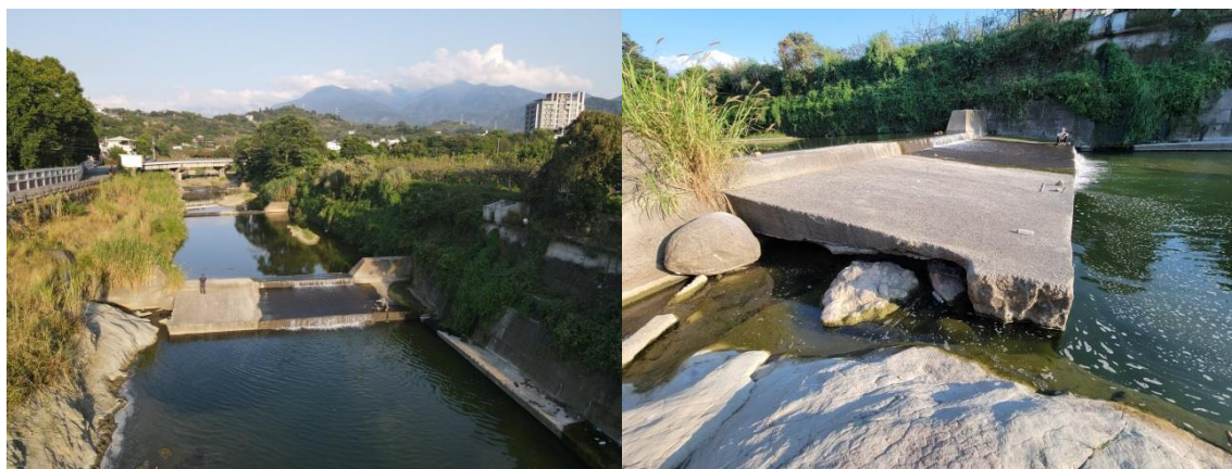
既有固床工下游掏空及左岸護岸基腳掏空
