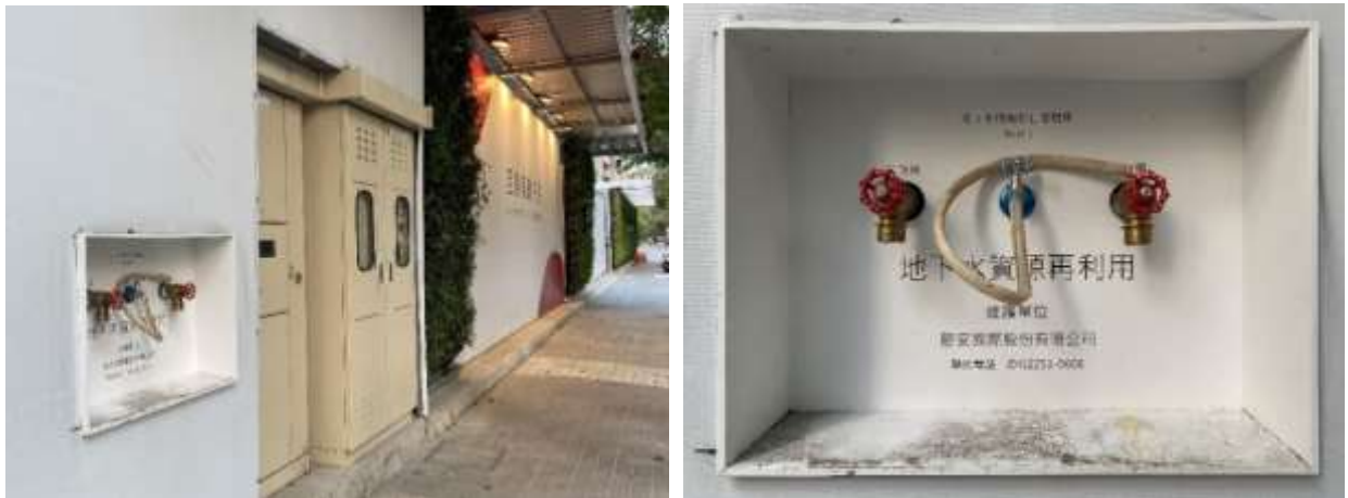
圖三、新建工地地下水資源再利用取水口
