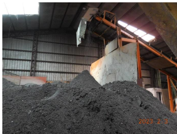
底渣再利用廠-設備運轉情況
