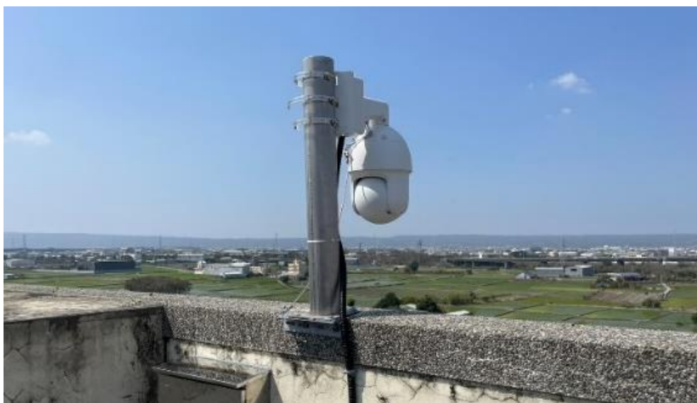
圖 6、現場監視設備
